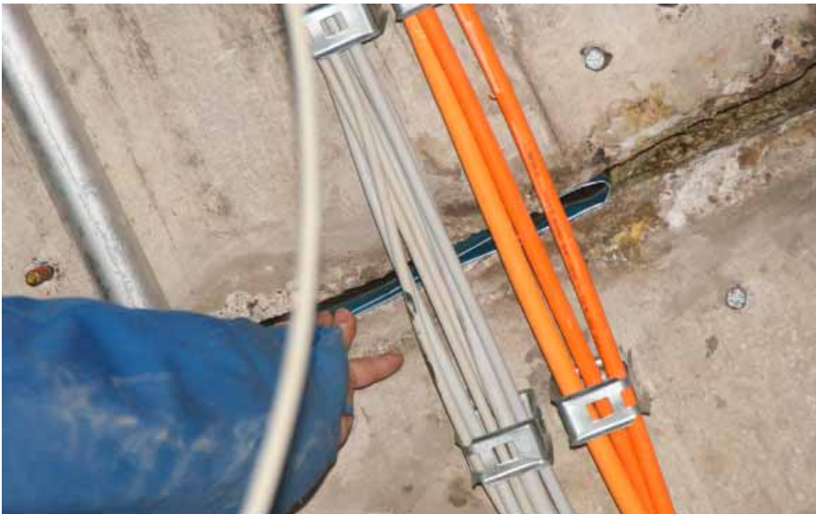
Typischer Einbau in Deckenbereich mit vorhandener Installation.
